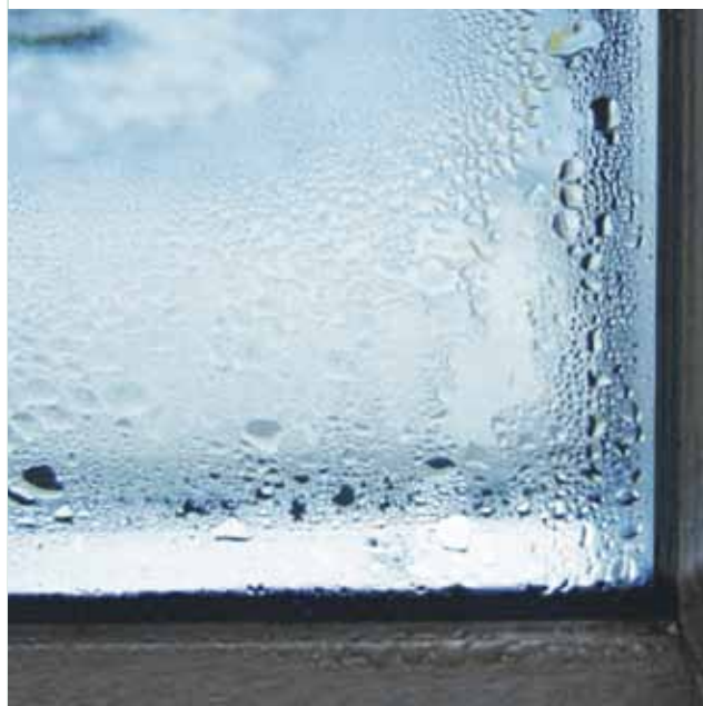
La condensation et la propagation des moisissures, à l'intérieur, en zone périphérique, ne sont plus qu'un souvenir.
